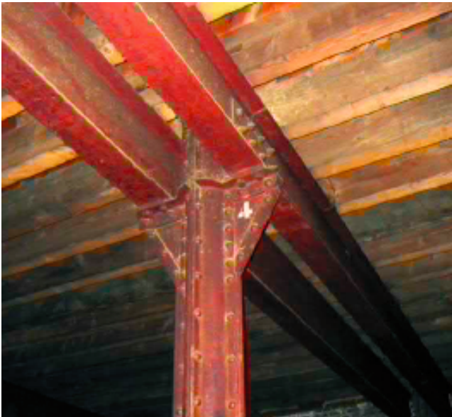
Image 3 : Plafond du 4e étage
